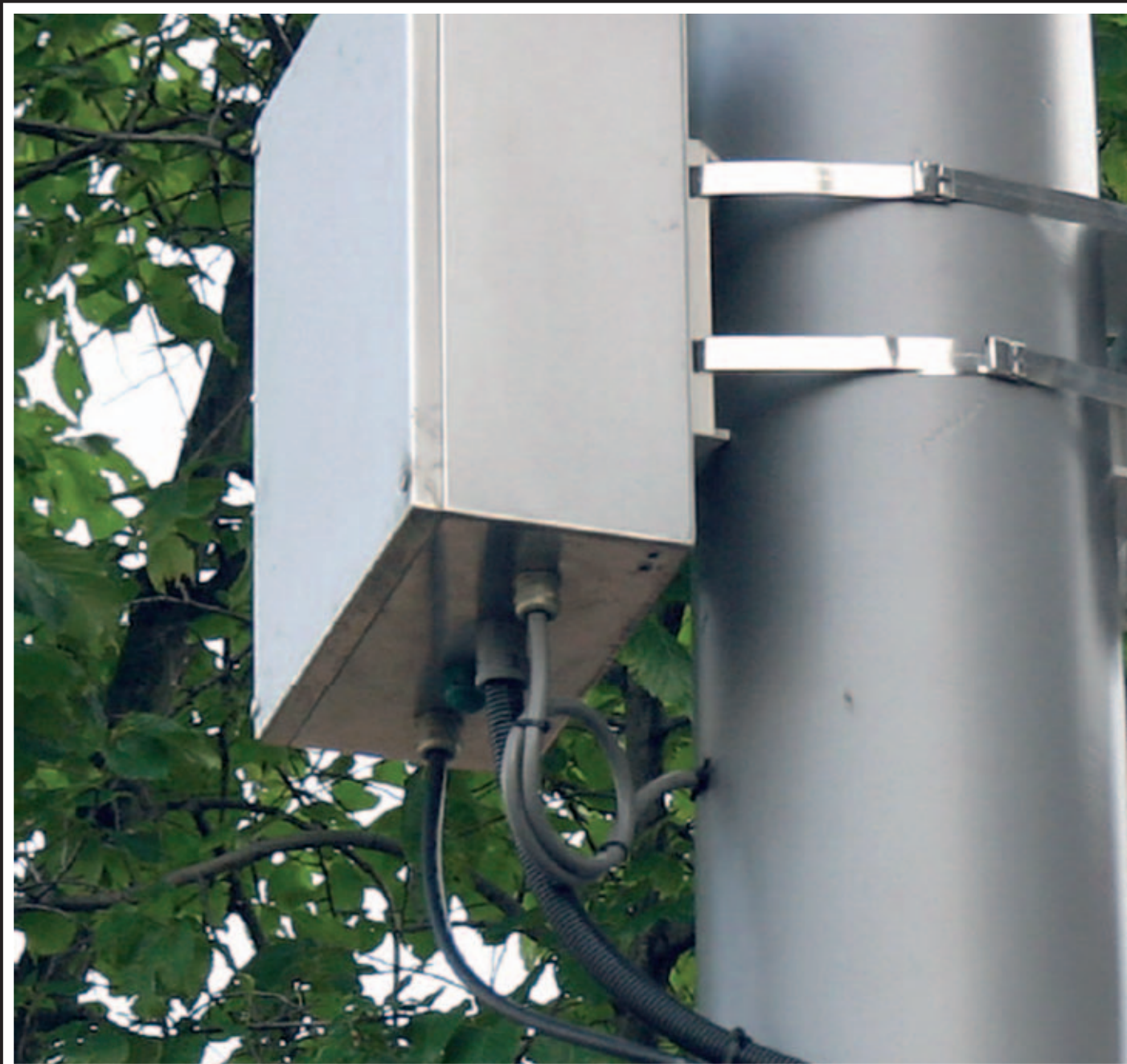
Instalación de cámaras domo IP inalámbricas en exteriores
